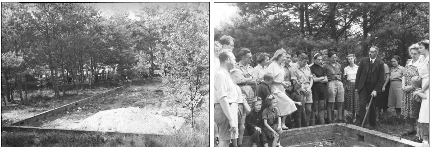
Dalton bouwkamp 1950 op Zonnewende. Op de fundamenten v/h VCJC kampeerhuis wordt nieuwbouw geplaatst. 2 e rechts mevr. A. Sillevis.
