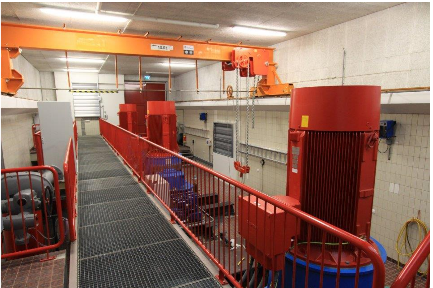
Opstelling van de drie pompen in de machinehal van het gemaal Gewande.
