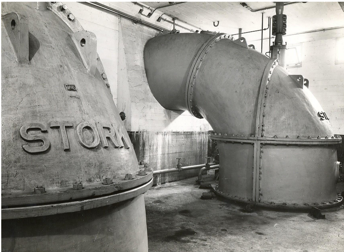
Pomp 1 en pomp 2 in de pompkelder van het hertogsgemaal.
